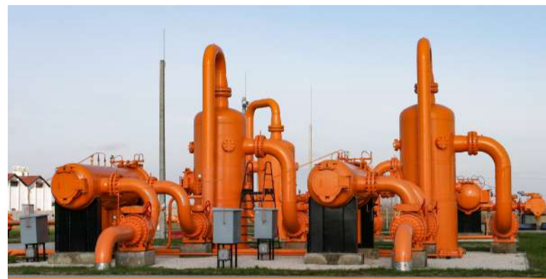
Компресорна станція Угорського оператора ГТС
