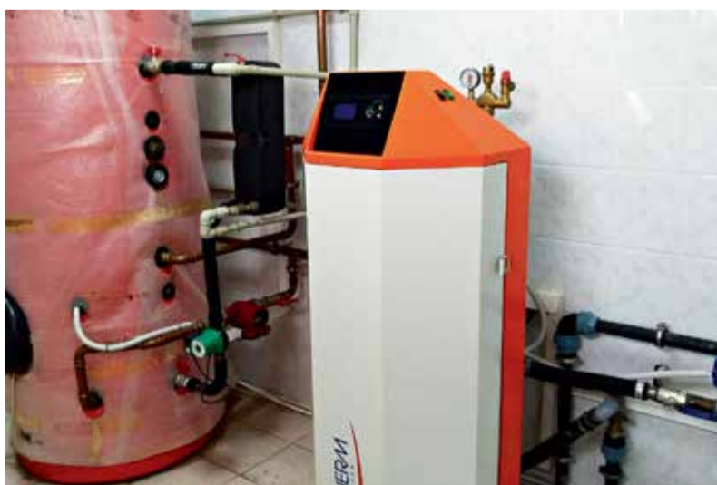
Тепловий насос обігріває виробничі приміщення площею 700 кв. м та влітку забезпечує його гарячою водою до 720 л за годину
