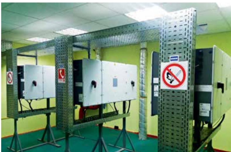
Інвертори – серце сонячної станції. Вони перетворюють постійний струм у змінний для передачі в мережу
