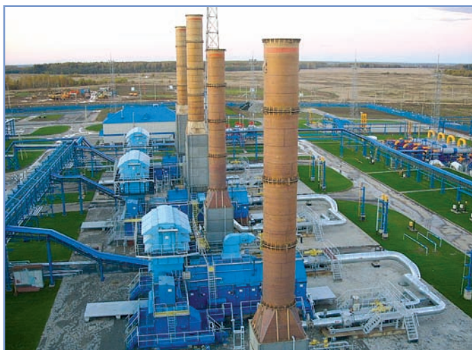
Рис. 2. Газоперекачивающие агрегаты последнего поколения на КС "Волоколамская"
