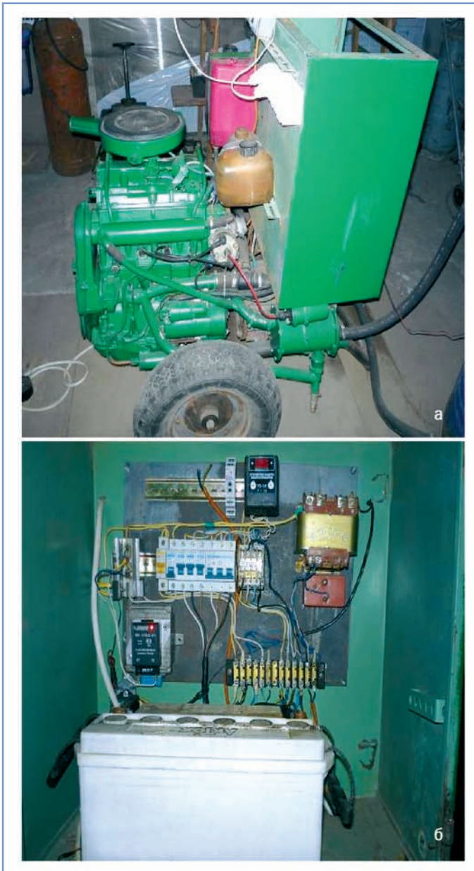
Рис. 4. Експериментальний стенд когенераційної установки: а – загальний вигляд; б – щит автоматики
