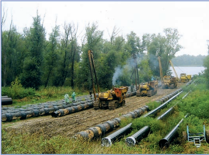
Підводний перехід магістрального газопроводу "Херсон-Крим" через р. Дніпро
