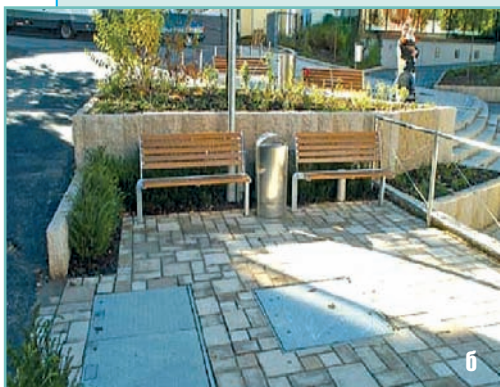
Підземна система регулювання тиску газу: а – підготовчі роботи; б – система здана в експлуатацію [2]
